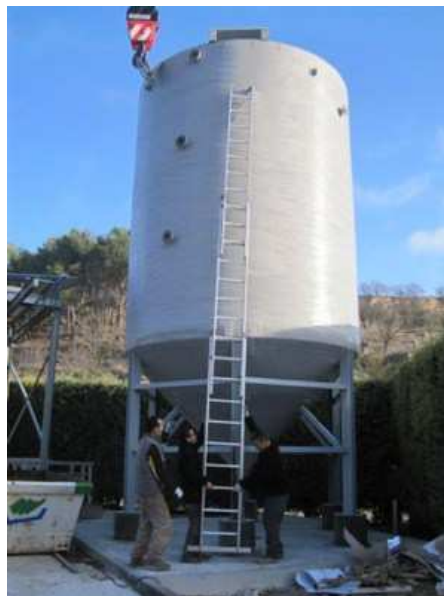
Nou espessorador EDAR Sta. Coloma
