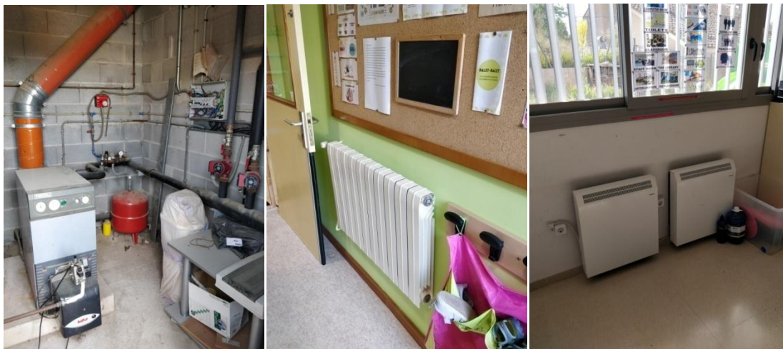
Fotografies 1, 2 i 3. Detall de la instal·lació actual de climatització a l'escola, llar d'infants i consultori mèdic de Barberà de la Conca
