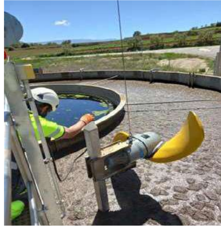
Vehiculador EDAR Solivella
