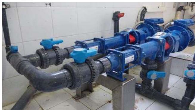
Nova injecció de polielectròlit EDAR Sta. Coloma de Queralt
